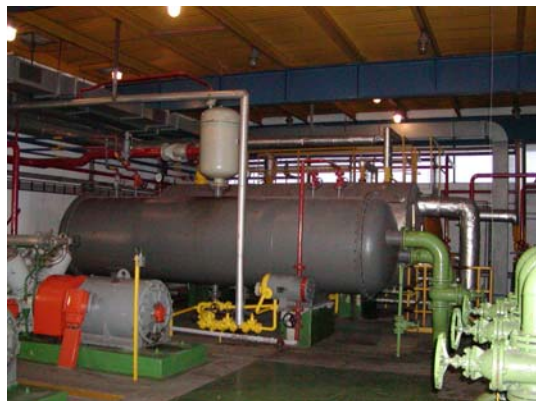
Foto č.1: Strojovna chlazení na zimním stadiónu
