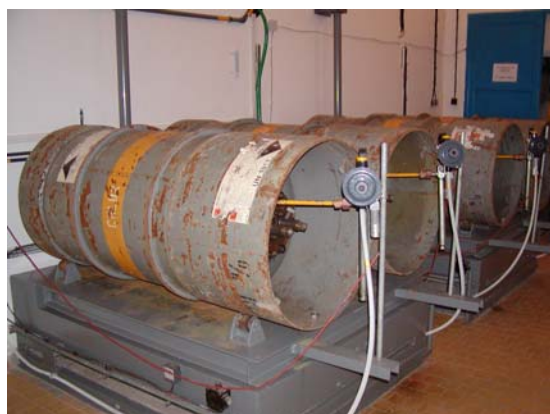
Foto č.3: Chlorovací stanice v úpravně vod
