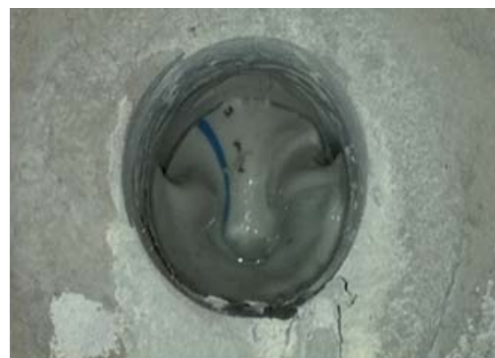
Obr. 8 Zatavený prostup PPR DN 40
