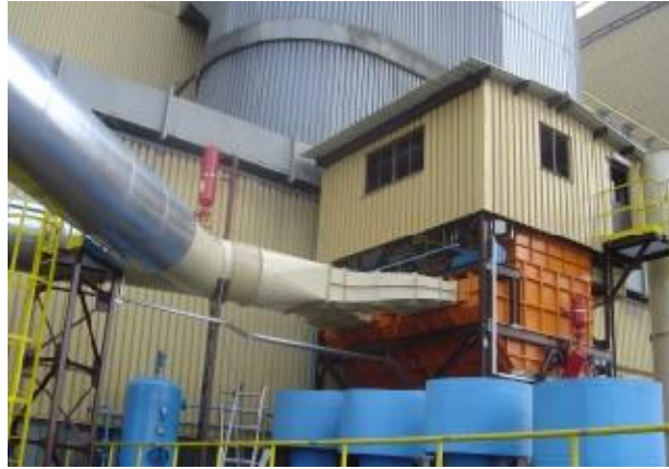
Obrázek č. 44 - Realizace HRD zařízení na potlačení exploze na filtrační jednotce na odsávání uhelného prachu
