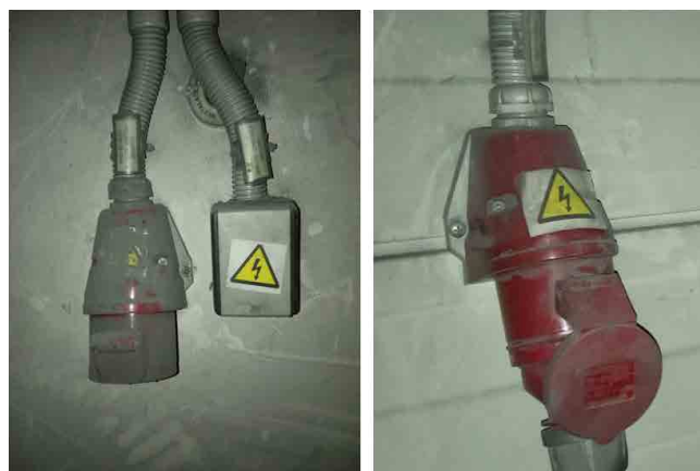
Obr. 5 Zásuvky umístěné vedle tkaninového filtru [autor]
