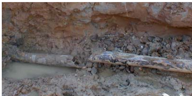
Obr. 3 Ukázka vniknutí kontaminujících látek do vodovodního potrubí při havárii
