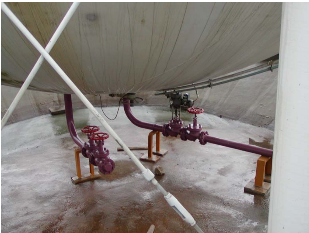
Foto č.3: Detailní pohled na nainstalovaný dálkově ovládaný ventil pod zásobníkem
