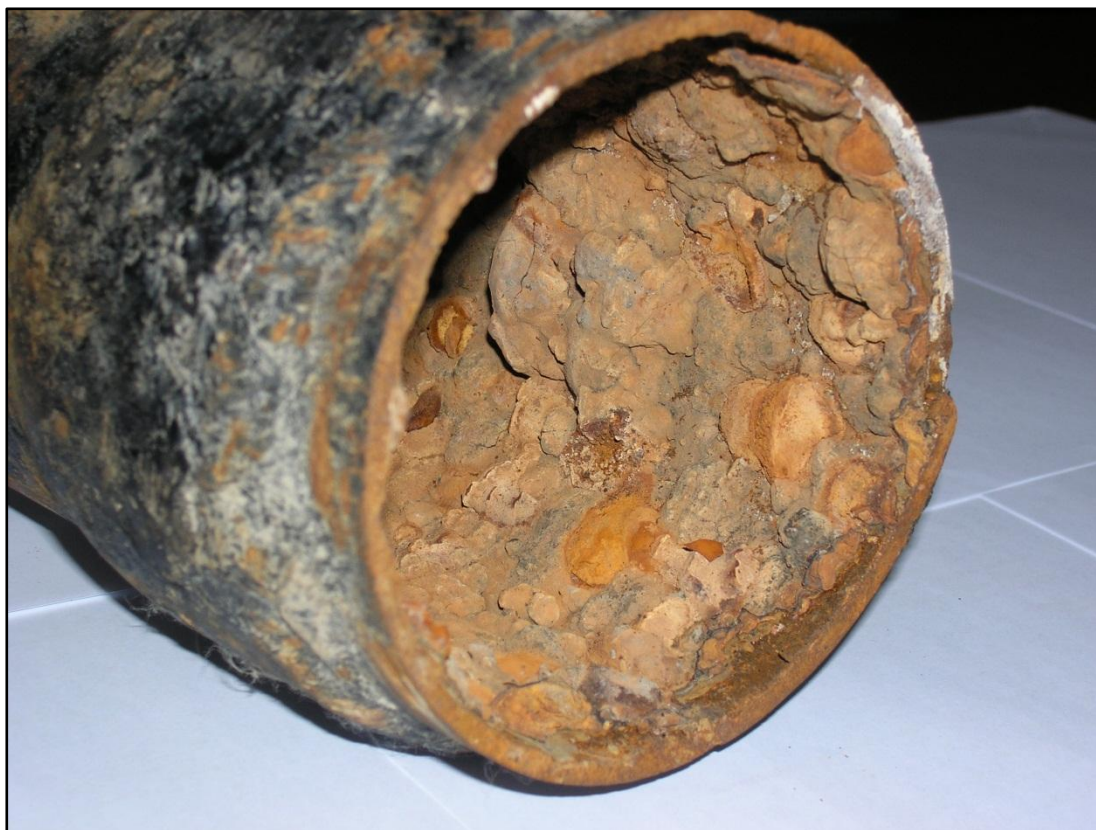
Obr.5.6 Požární potrubí se sníženou hydraulickou účinností vlivem inkrustace
