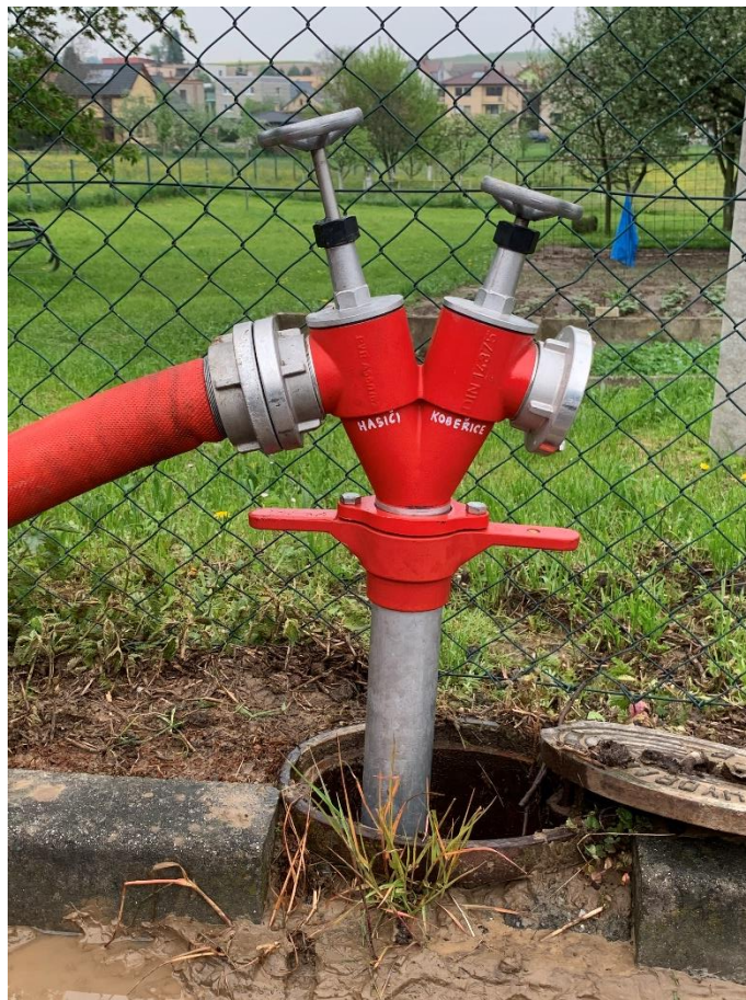
Obrázek 19 Hydrantový nástavec napojený na podzemním požárním hydrantu
