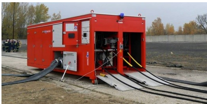
Obrázek 6.5 Čerpací jednotka připravená k čerpání vody [2]
