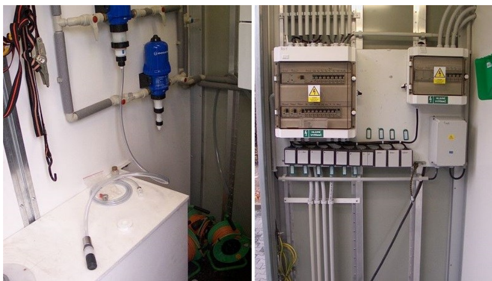
Obrázek 4.9 Detail rozvodné části vody a elektro v technologické části
